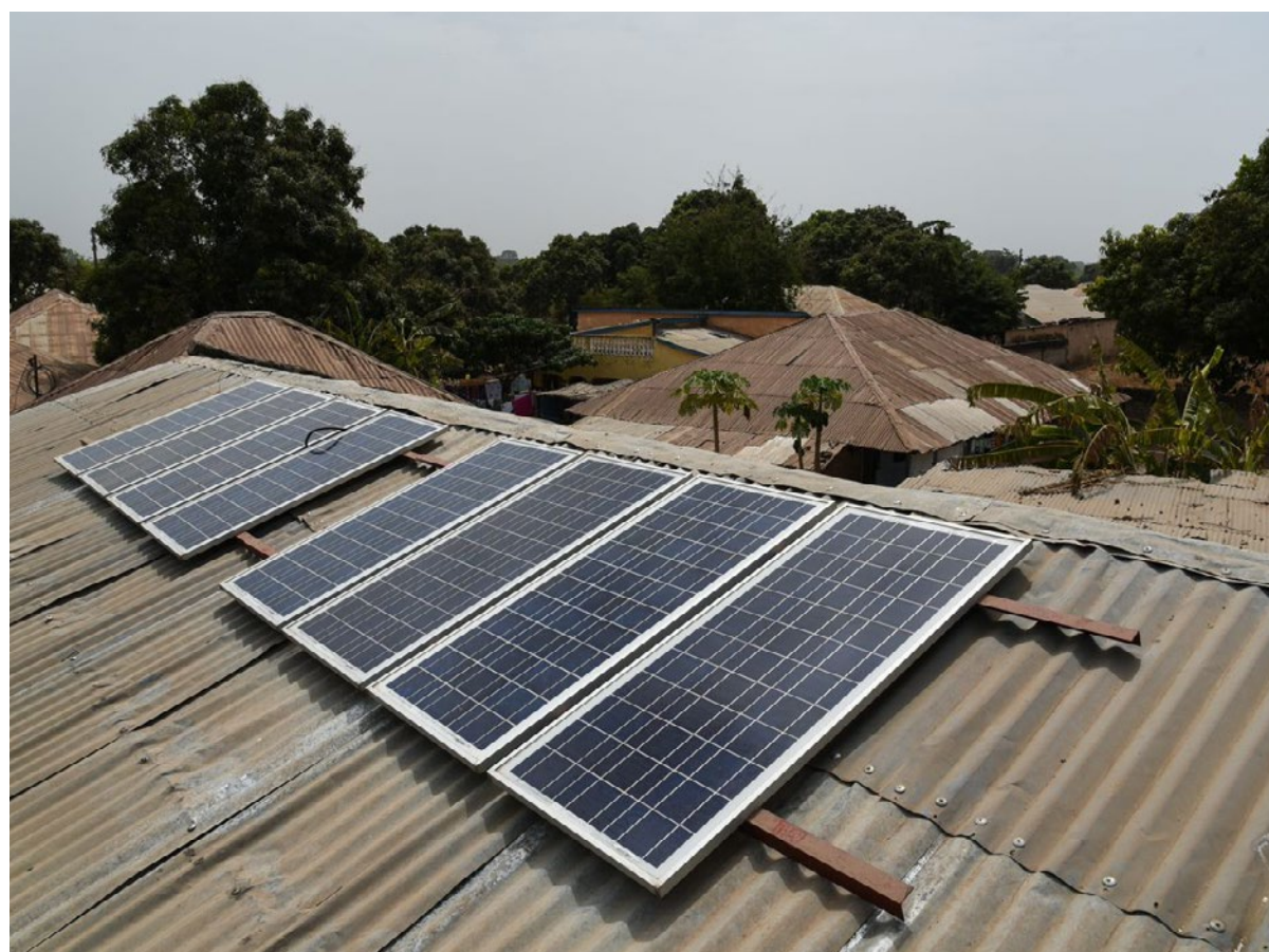
Figura 7: Sistema solar caseiro instalado.
