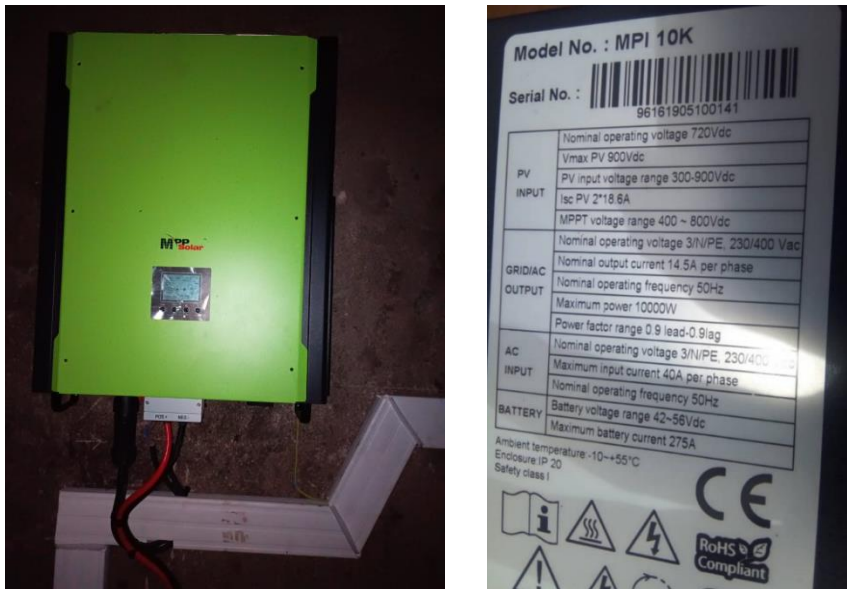
Figure 6 : Onduleur de 10 kW
